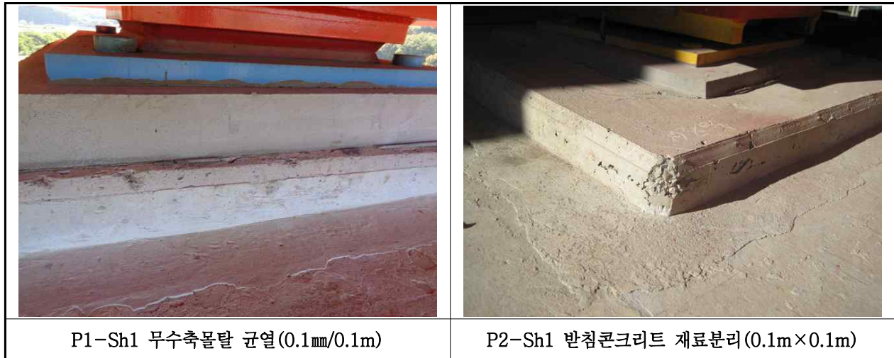
【사진 30.3.13】 교량받침 손상현황
