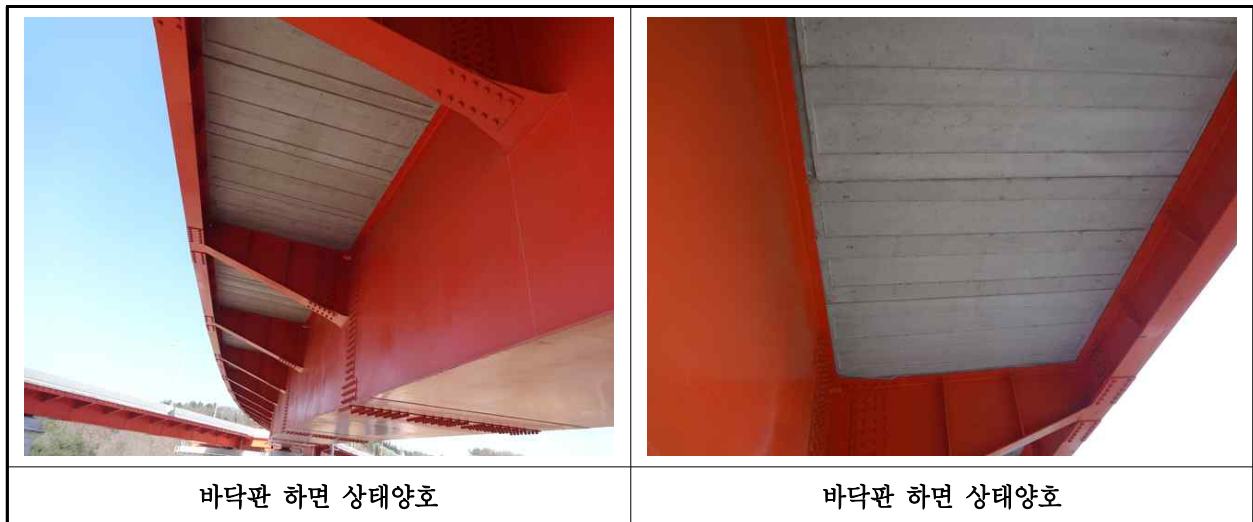
【사진 30.3.3】 바닥판하면 손상현황
