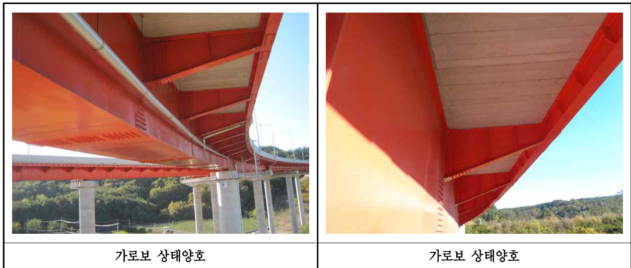
【사진 30.3.7】 가로보 손상현황
