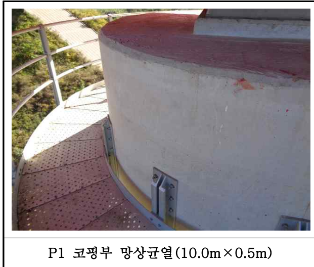
【사진 30.3.11】 교각 손상현황
